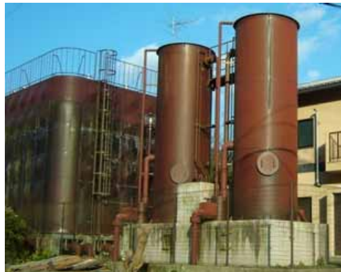
大原簡易水道 第2浄水場: 急速ろ過方式
