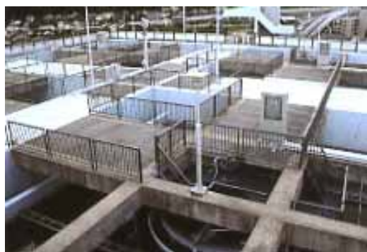
屋上に配置された水処理施設
